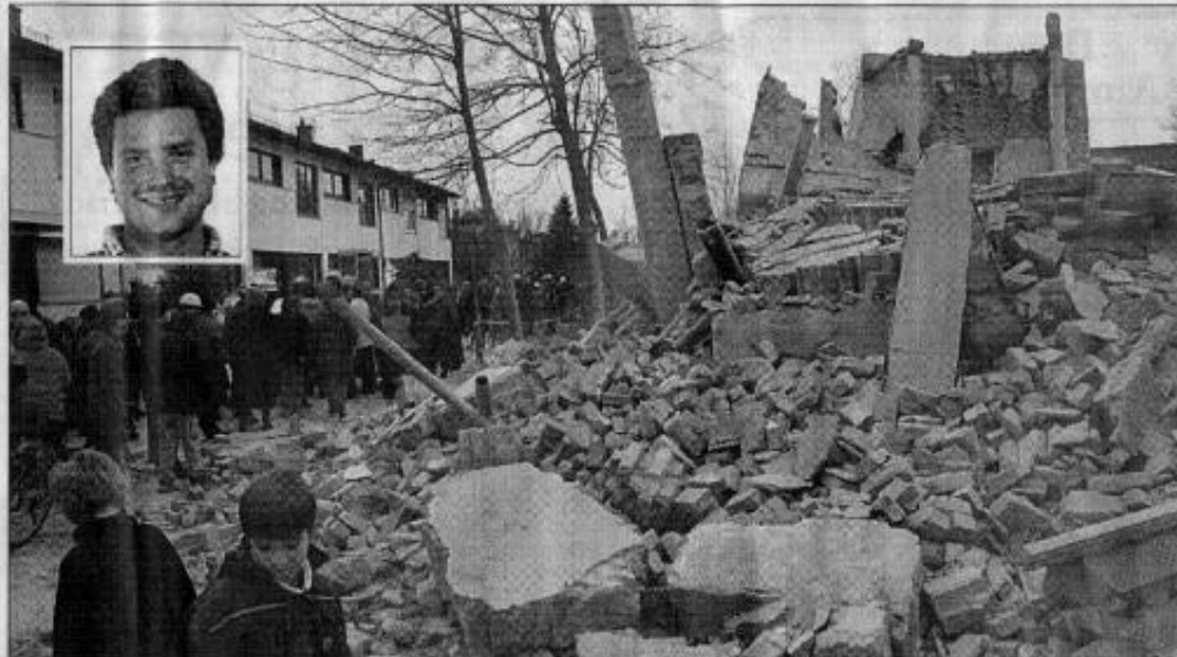
Unter der Regie von Sprengunternehmer Andreas Fickl (kleines Bild) brach ein Wasserturm in Kirchheim bei München zusammen. Das Ergebnis: 650 Tonnen Trümmer. Fotos: fkn
